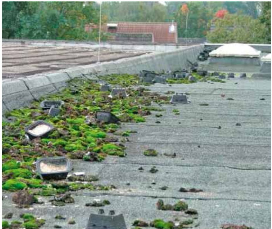
Verwahrlostes Flachdach – Die Inspektion und Wartung ist eigentlich als eine wesentliche Sorgfaltspflicht des Bauherrn oder des Betreibers zu sehen.
